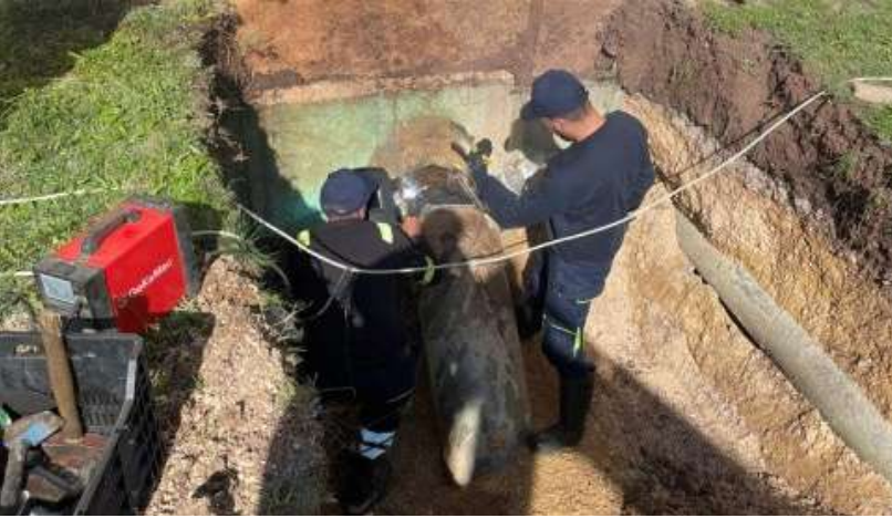
Sazova Atıksu Terfi Merkezi
