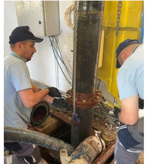
Çifteler Paket Arıtma Tesis
