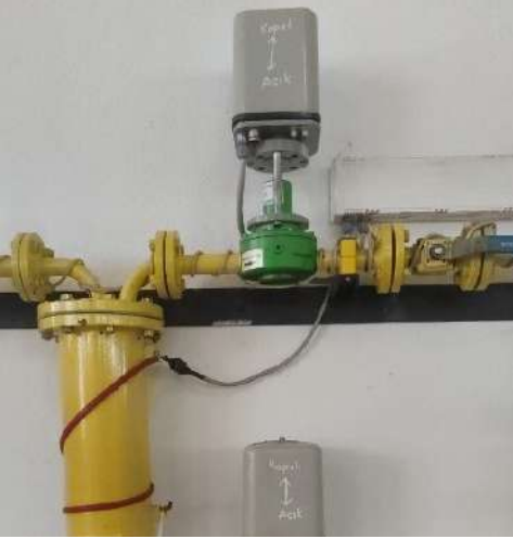
Klorlama Ünitesi Ekipmanları
