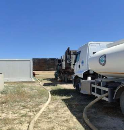
Rahmiye Paket Arıtma Tesisi
