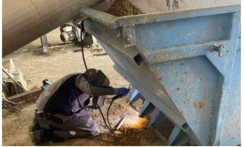
Atıksu Arıtma Tesis
