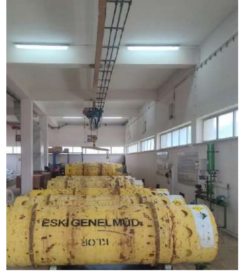
Gaz Klor Tankları
