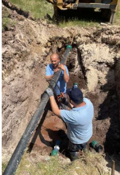
185 Binası Temizsu Hattı
