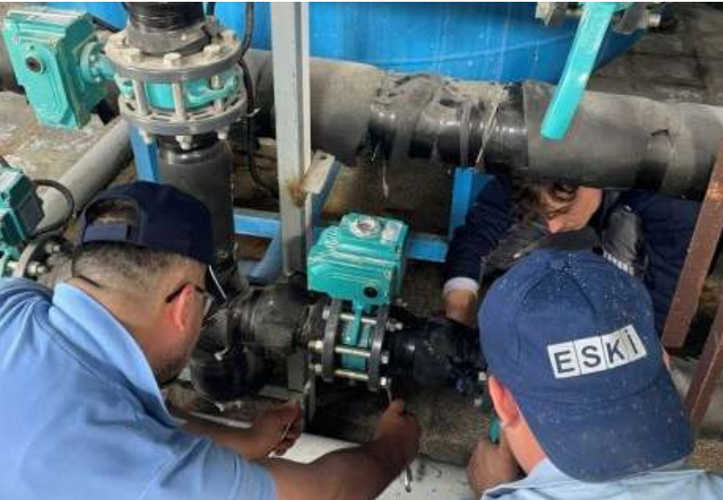
Kırka – Bozan Paket Arıtma Tesis
