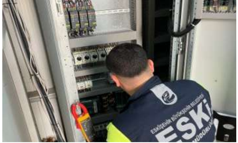
Çifteler Paket Arıtma Tesisi
