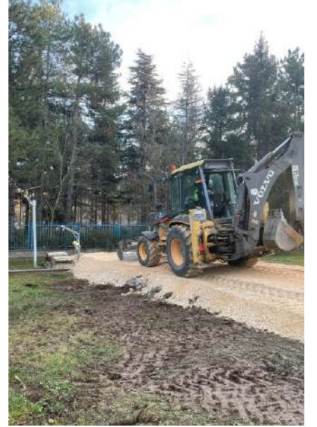
Atıksu Terfi Pompa İstasyonu
