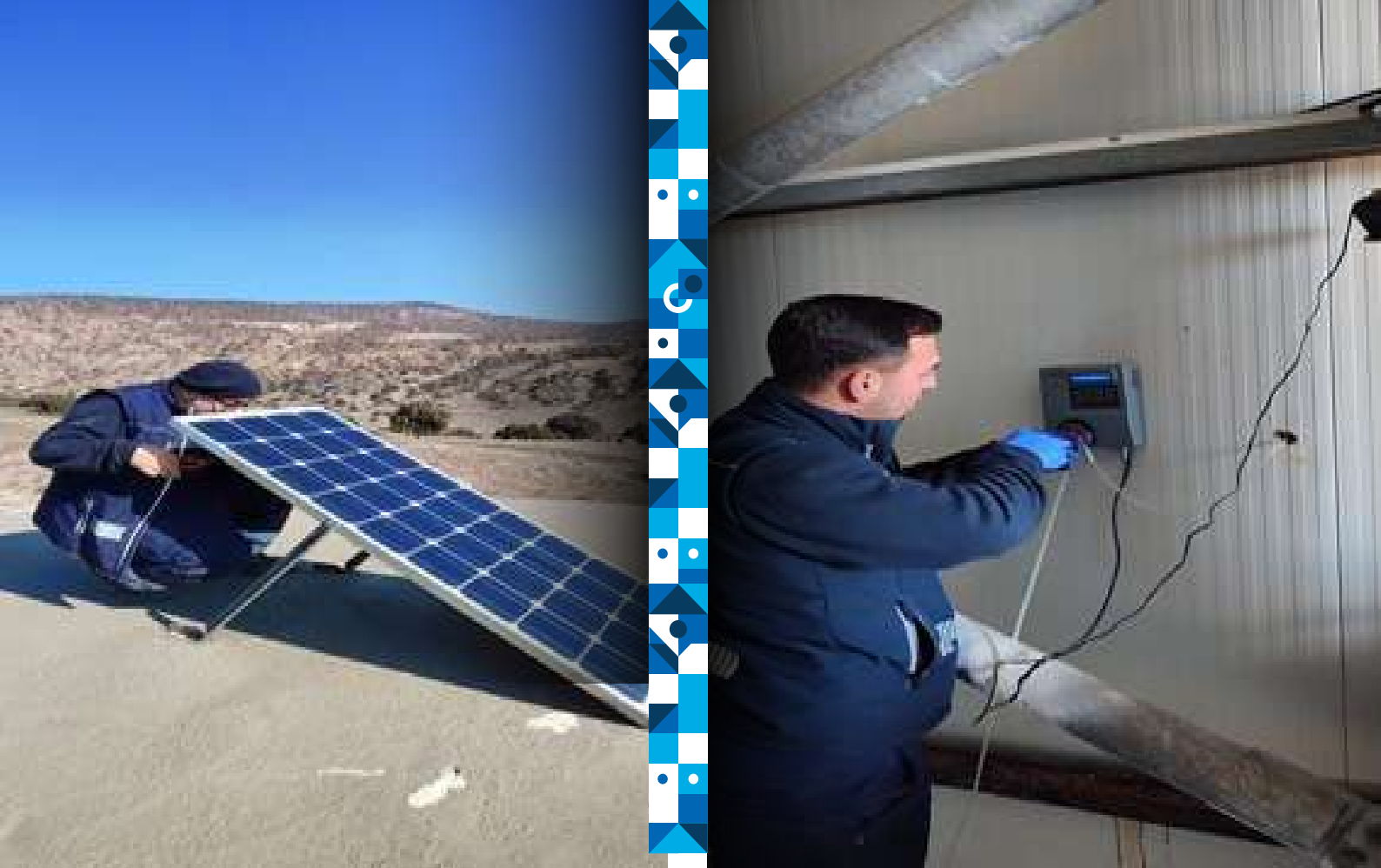
İçme ve Kullanma Suyu Deposu Solar Enerji Sistemi Bakımı
