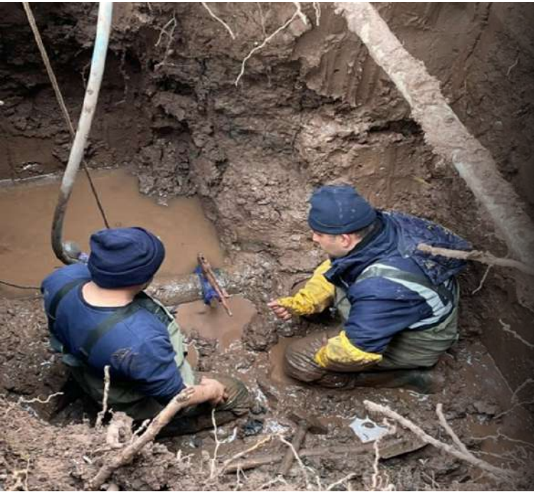
Hidrant Kaçağı Giderilmesi
