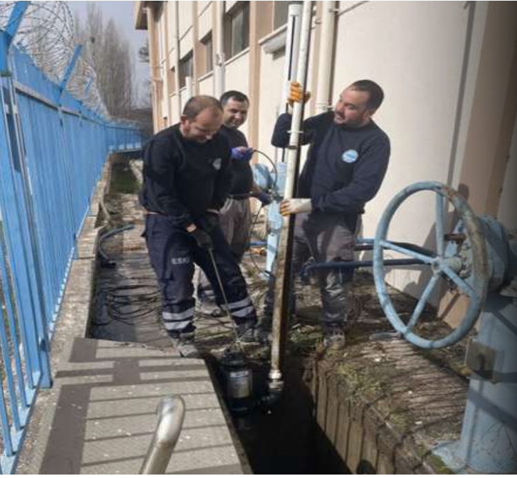
Hamsu Numune Pompası Montajı
