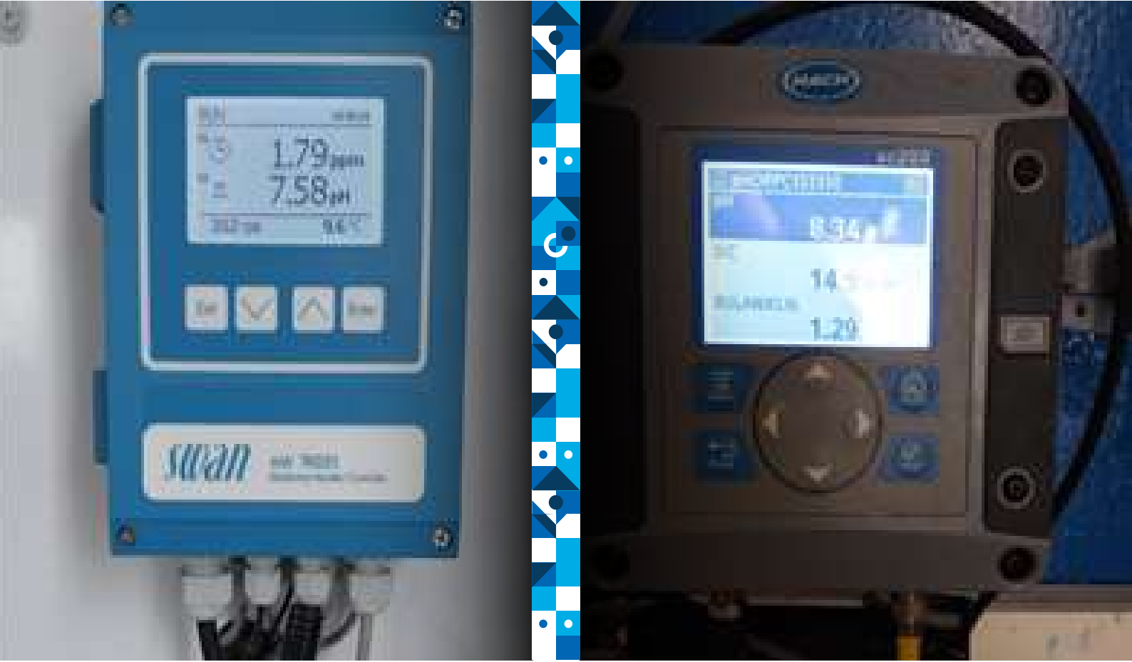
Şehir Şebeke Suyu Depo ve Arıtma Tesisi Cihazları
