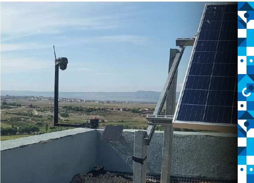
Güvenlik Kamerası Montajı
