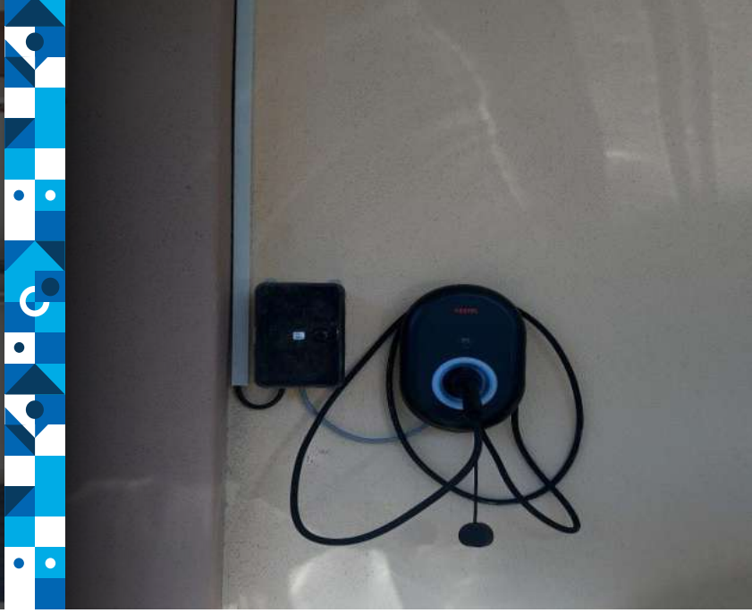
Elektrikli Şarj İstasyonu
